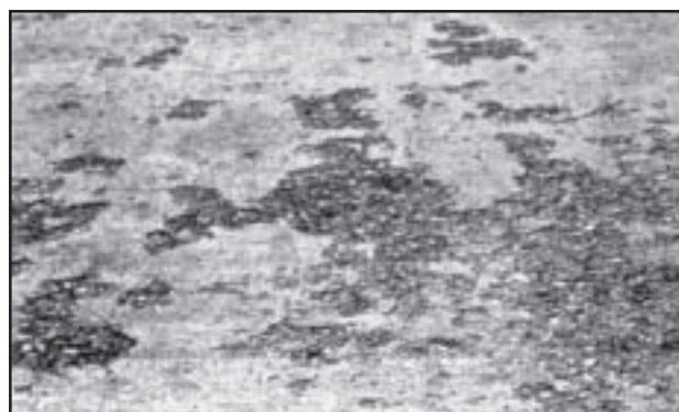
Descascaramiento de las superficies de concreto
