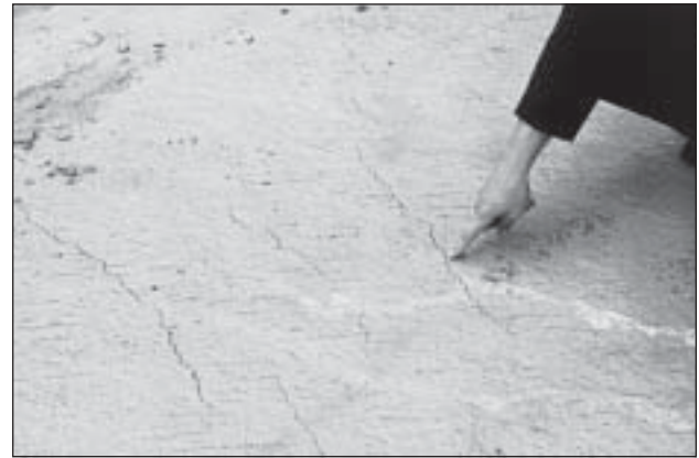
Agrietamiento por contracción plástica
